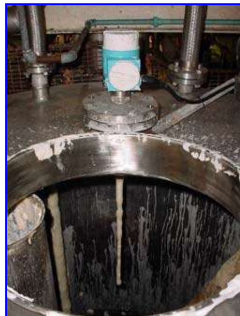
Εφαρμογή βελόνας χωρητικότητας σε δεξαμενή καυσίμων
